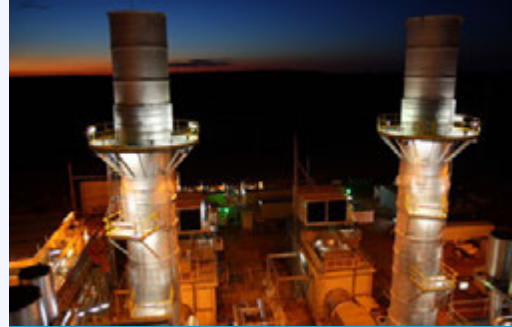
Bypass and HRSG Exhaust Stacks
