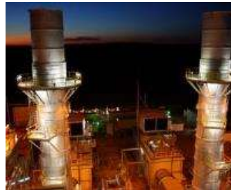
Bypass & HRSG Exhaust System
